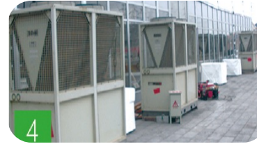
4 空调 Air condition
